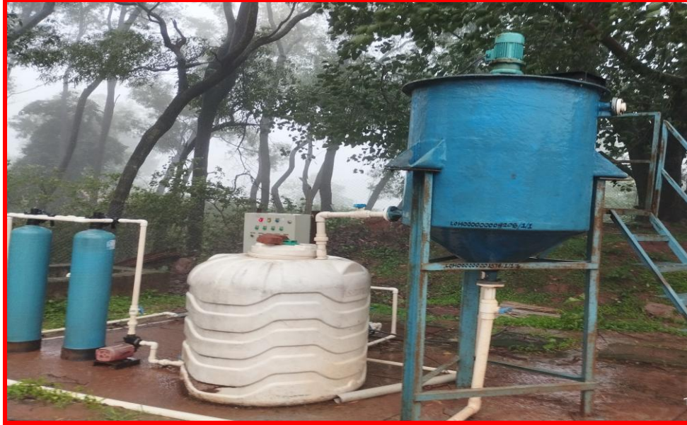
Effluent treatment plant (ETP)
