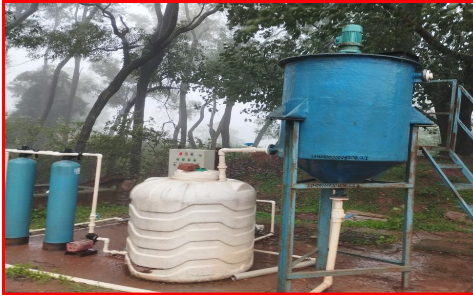
Effluent Treatment Plant (ETP)
