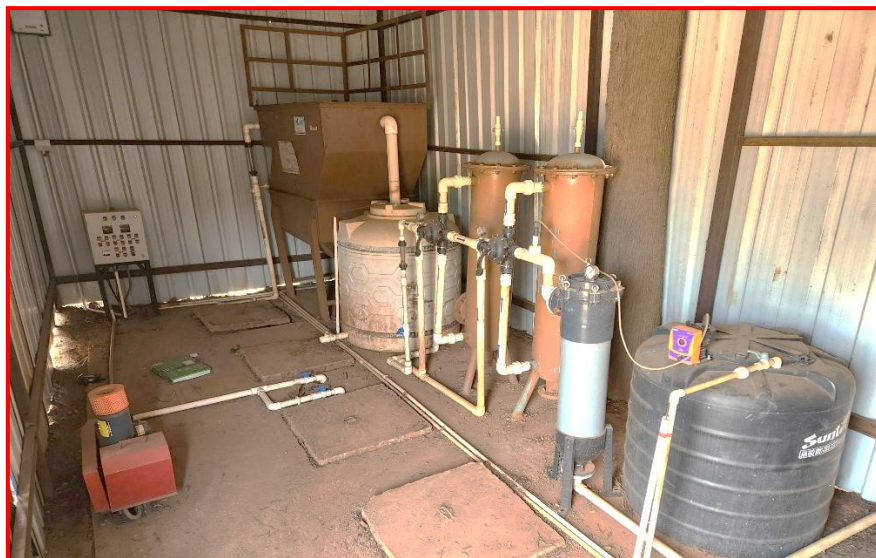
Effluent treatment Plant (ETP)
