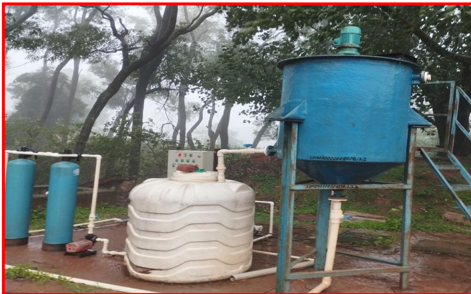
Effluent Treatment Plant (ETP)
